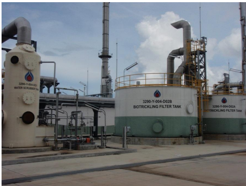
รูปที่ 3-33 ระบบ Biotrickling Filter Tank
