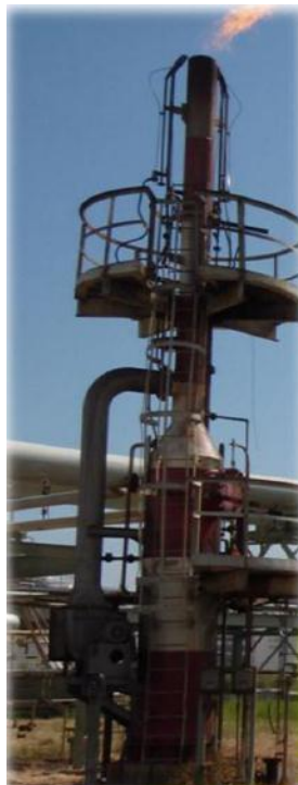
รูปที่ 3-14 Ground Flare
