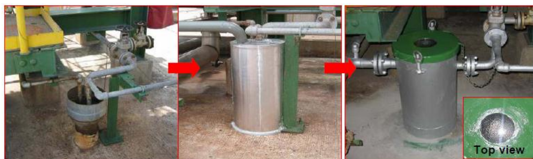
รูปที่ 3-6 เปลี่ยนภาชนะรับสารปล่อยทิ้งเป็นระบบปิด
